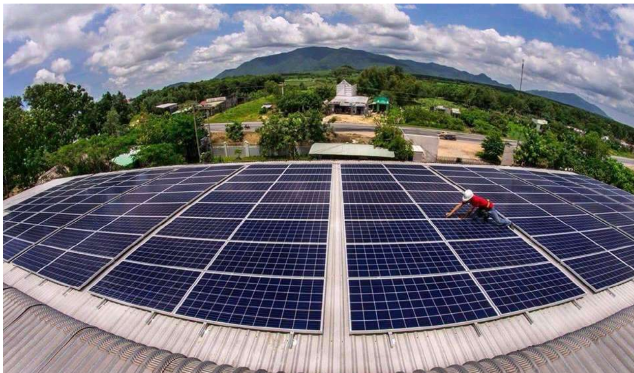
Hệ thống điện năng lượng mặt trời tại Công ty Khai Anh Bình Thuận
