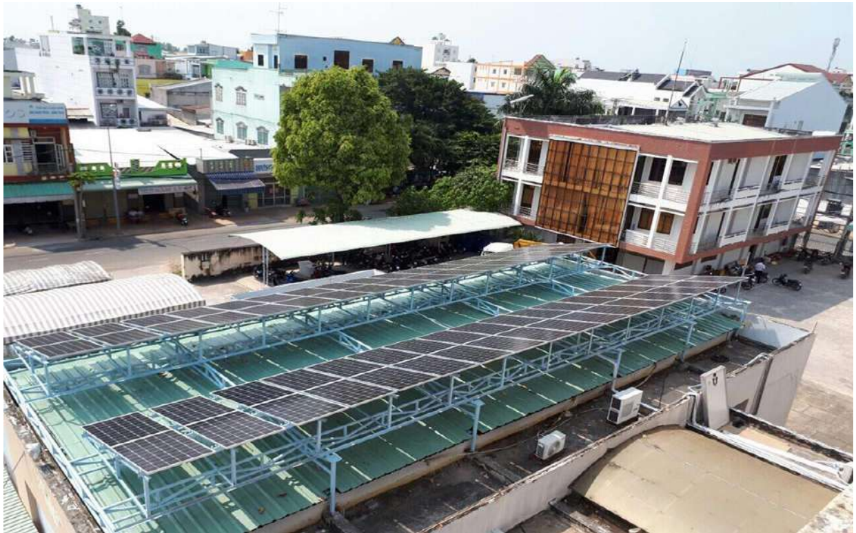
Hệ thống điện năng lượng mặt trời 98kWp tại Công ty Điện Lực Đồng Tháp
