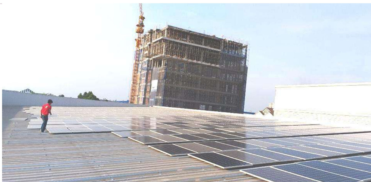
Tận dụng diện tích trên mái nhà xưởng để lắp Pin mặt trời
